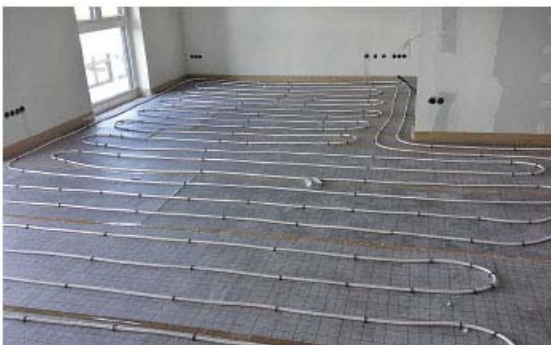
Wohltige Wärme: Eine Fußbodenheizung ist sparsam und erzeugt ein gutes Raumklima. Foto: PassivEnergie Wohnbau GmbH & Co. KG
