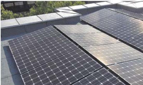
Hier kommt der Strom vom Dach: Im Effizienzhaus sind auch Solarzellen verbaut. Foto: PassivEnergie Wohnbau GmbH & Co. KG
